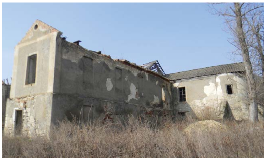
Північно-східний фасад садиби баронів Местмахер у с. Песець Новоушицького р-ну. Фото автора, 2017 р.
